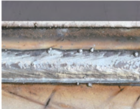
Salpicadura y socavado
